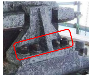
写真1 橋梁支承部の腐食ボルト (溶融亜鉛めっき) 1)
