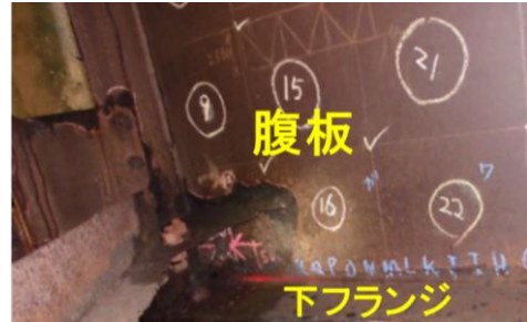
図-3 実橋梁の腐食例(パターン8)
