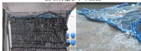
写真 3. シート剥離状況 (左)新材(右)腐食体⑩
