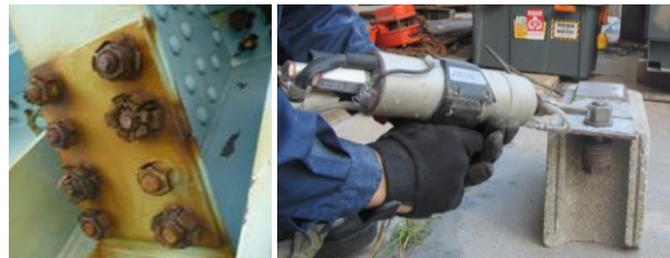
写真 1 腐食高力ボルト 写真 2 Cold Spray 施工状況
