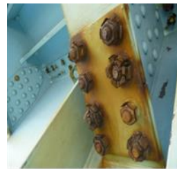
写真 1.1 高力ボルトの腐食状況
