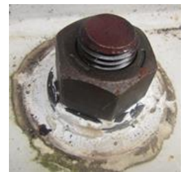
写真 2.2 つばのみ接着ボルト の劣化状況
