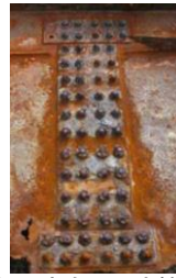
写真1. 腐食した摩擦接合継手
