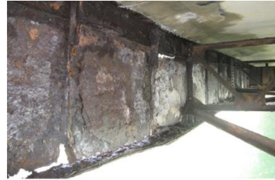
写真1: 激しい腐食損が生じた桁端部
