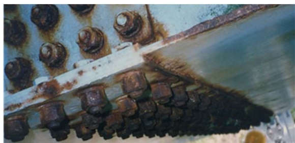
写真 1 腐食劣化したボルト部
