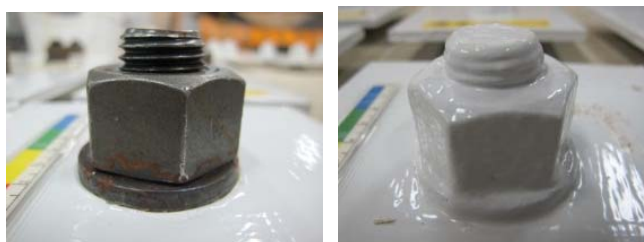
写真 2.1b 左: 新材ボルト 右: 補修塗装ボルト
