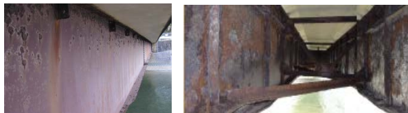
写真 1.1 桁内、桁外の腐食
