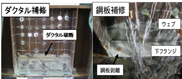
写真4 各補修における破壊状況
