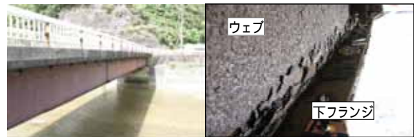
a)鋼プレートガードラー橋 b)桁内部の腐食状況 写真1 鋼橋の腐食事例
