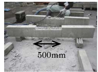
写真 1 塩害による剥落模擬
