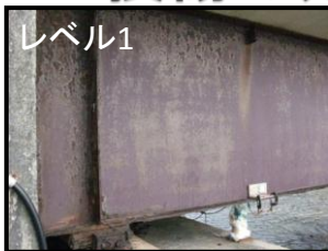
腐食は見られるが 部材破断が見られない
