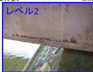
ウェブと下フランジ境界に 破断が発生し始めた時点
