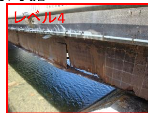
ウェブ母材に亀裂が見られる場合 下フランジが破断した場合
