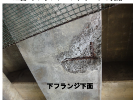
A2部 下フランジコンクリートの剥落
