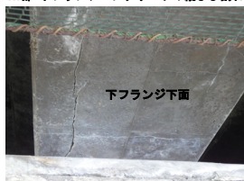
A1部 下フランジコンクリートの縦ひび割れ
