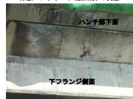
床版コンクリート(張出部)の剥離
