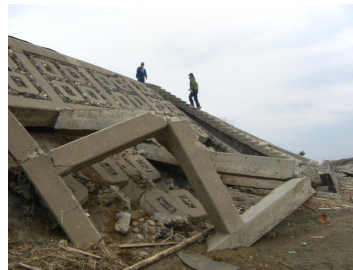
岩沼海岸の海岸保全施設損壊 (陸域部)
