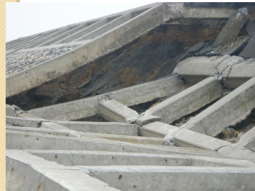
岩沼海岸の海岸保全施設損壊 (陸域部) 護岸背面の損傷
