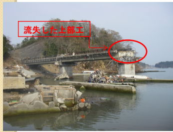
①国道45号歌津BP橋梁上部工が流失
