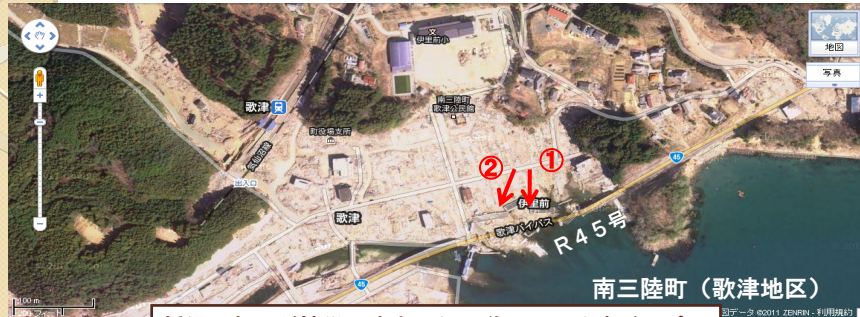
橋梁上部工が被災し流失した国道45号歌津バイパス
