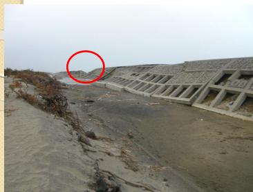
岩沼海岸の海岸保全施設損壊 (陸域部) ○破堤箇所
