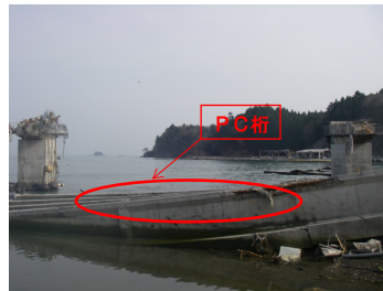
②国道45号歌津BP流失したPC桁
