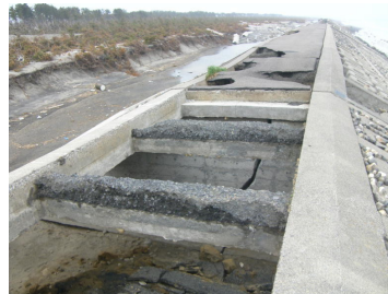
岩沼海岸の海岸保全施設損壊 (護岸天端部) 内部材が流失
