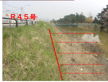
② R 4 5 石巻市付近（海側盛土部） （津波による塩水により雑草が枯死）
