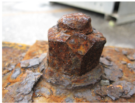
腐食ボルトナット部
