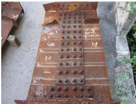
腐食した添接板
