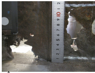
下部が腐食減厚
