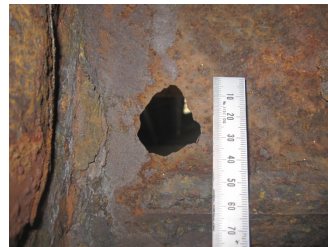
水平補剛材近傍が腐食減厚
