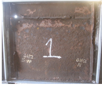
試験体4(水平補剛材や中央が腐食)
