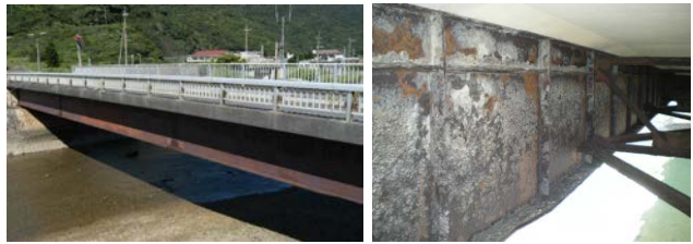
写真1 研究対象橋の全景と腐食状況
