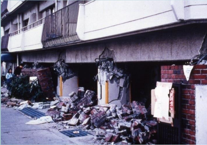
7階集合住宅1階柱部倒壊
