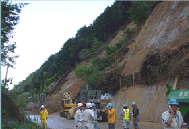
国道での大規模な土砂災害 (愛媛県新居浜市付近)
