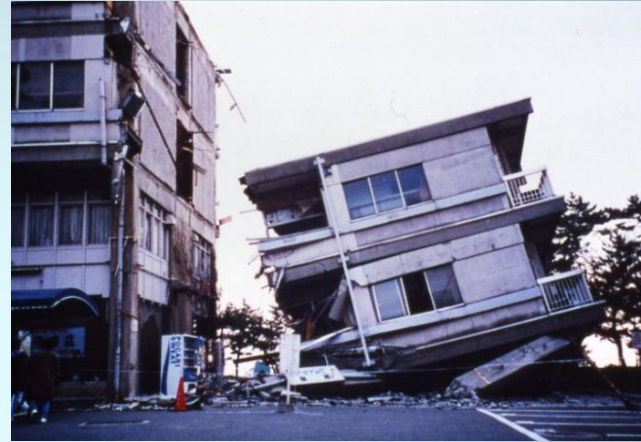
4階建物増築部倒壊
