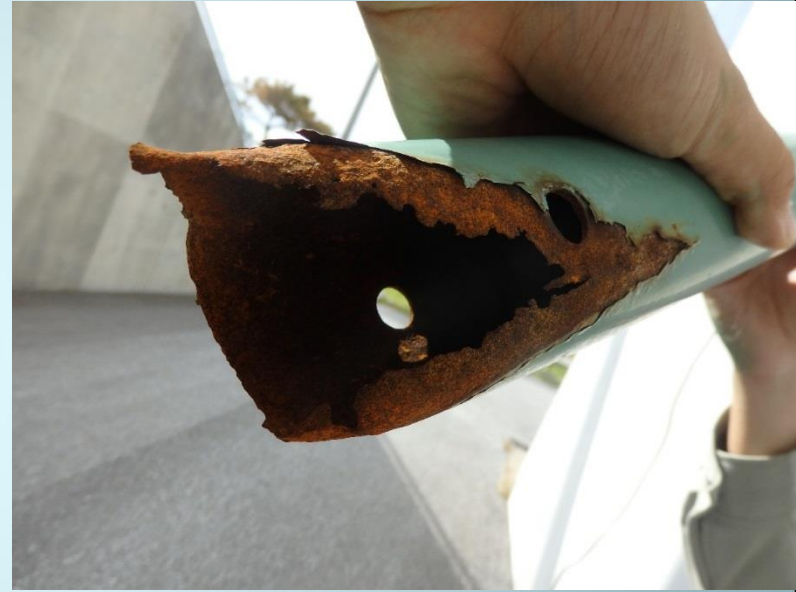
破壊部の腐食減肉。
