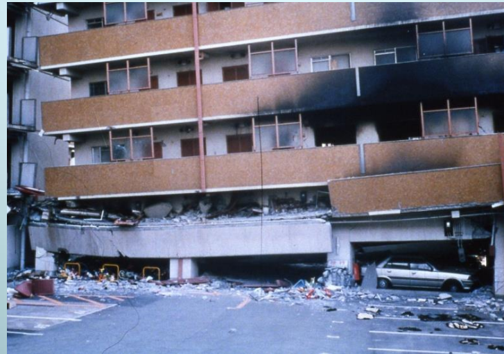
ピロティー形式建物倒壊
