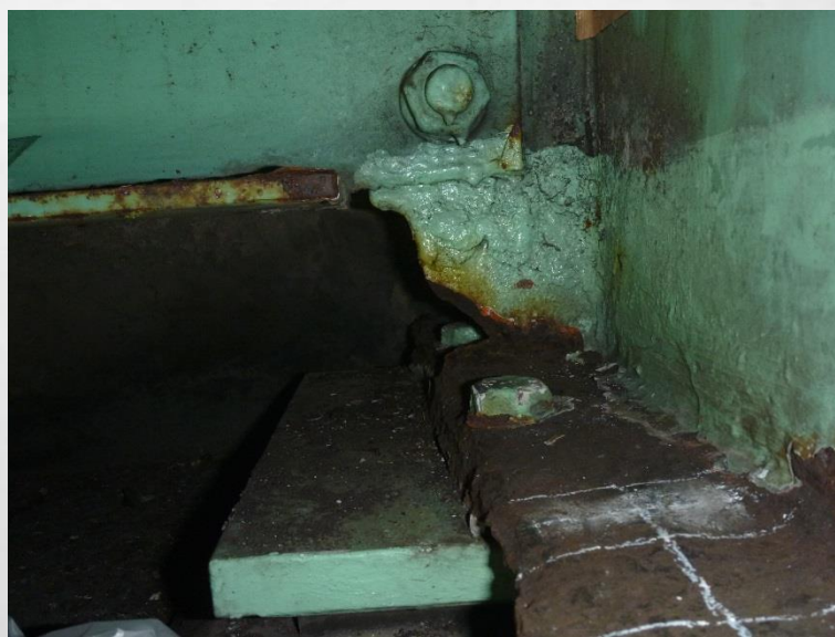
桁端部の腐食状況
